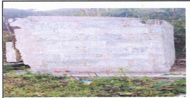
Foto 6: Se observa al modulo de letrinas en mal estado
